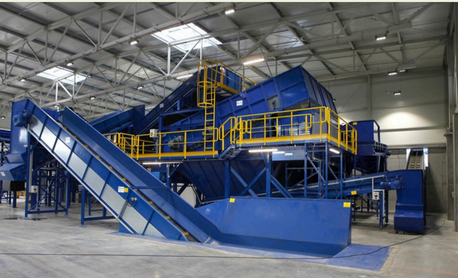
Zakład Mechaniczno Biologicznego Przetwarzania Odpadów w Zabrze FCC Śląsk.
